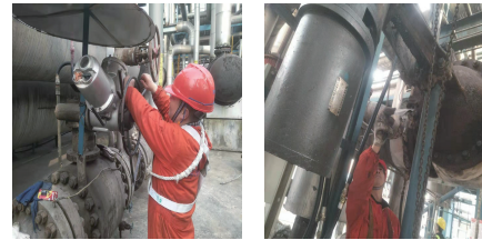
达州公司电仪部检修人员李晓华、简朝东等在办理好第二种工作票并对设备停电后，对电动阀控制板、密封状况、传动机构、限位开关及电机进行检修和测试。
